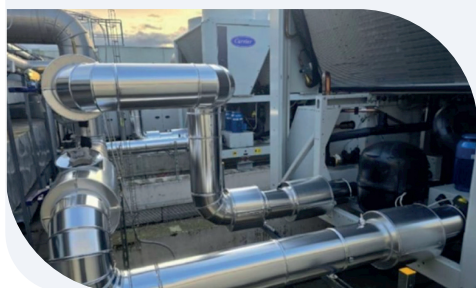
POMPES À CHALEUR
